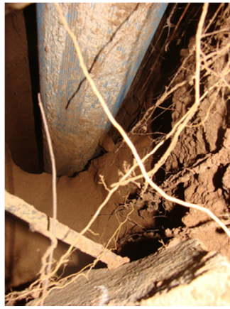
Figura 3 - Exemplo de falta de proteção sanitária/cimentação.
