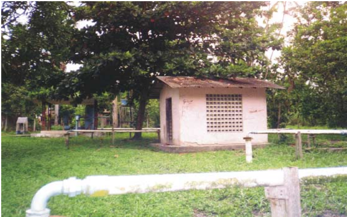
Foto 01 - Bateria de poços da COSANPA utilizado para o abastecimento de água à população.
