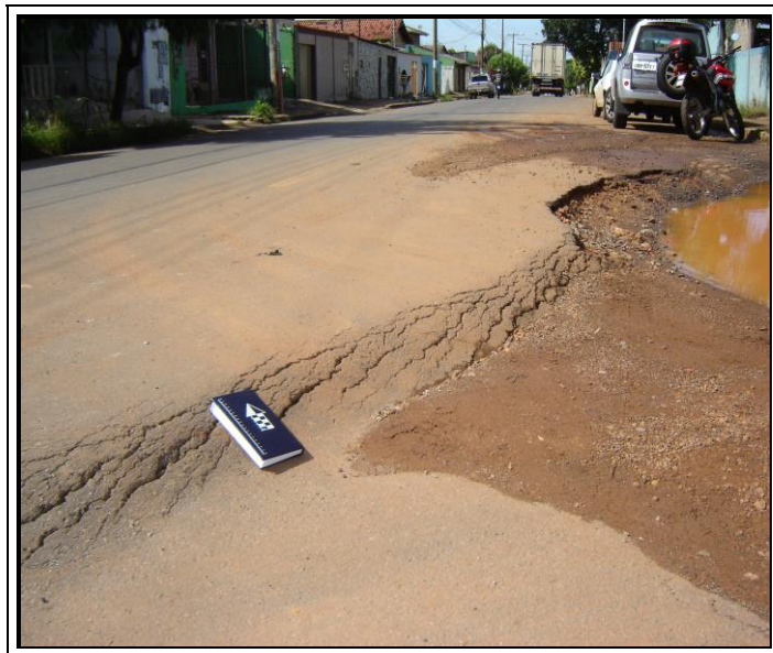
Figura 2 – Formato geométrico na Avenida Leopoldo de Bulhões, mostrando o avanço da erosão.
