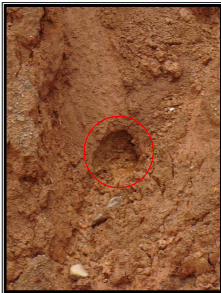
Figura 6 - Avanço da erosão com detalhe para o processo de piping.
