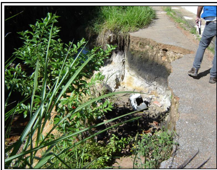
Figura 8 – Erosão na margem do córrego destruindo o asfalto da rua Pedro Martins.
