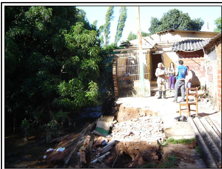
Figura 9 - Erosão na margem do córrego invadindo residência.
