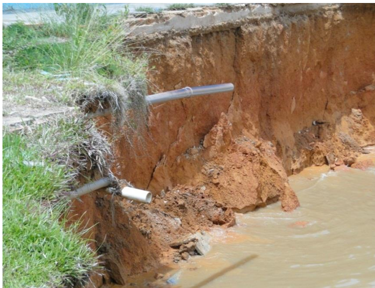
Figura 15. Lançamento de águas servidas no talude erodido.
