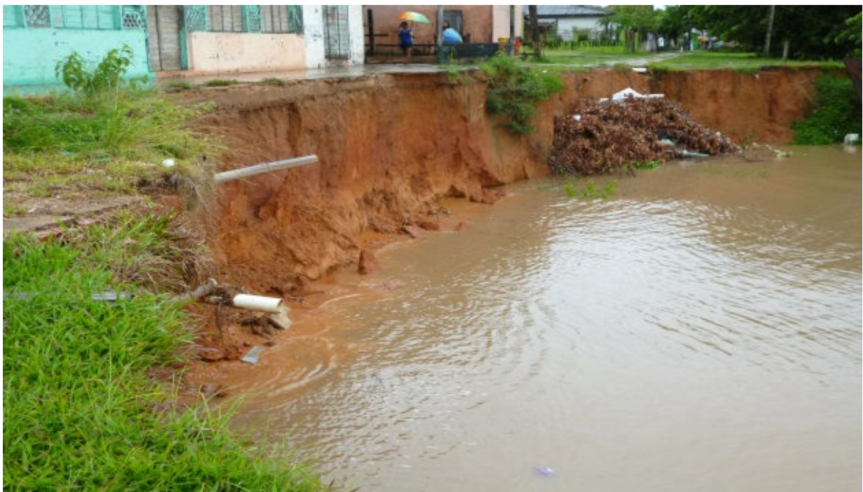
Detalhe da margem em processo de erosão - Margem direita.
