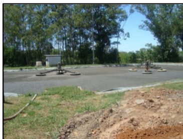
Figura 5 Estação de tratamento de efluente.
