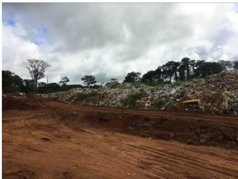
Figura 7. Aspecto geral da disposição de lixo na Área 2.
