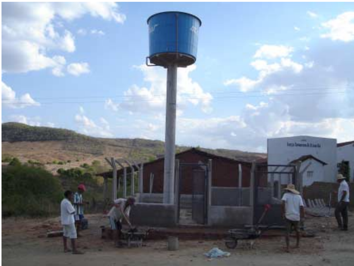
Foto 7.1 - Cercado de proteção e caixa elevada do SSA Sítio Tipi de Cima
