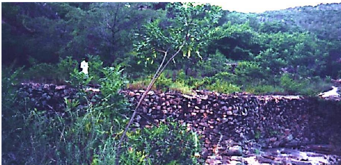
Figura 5 – Barragem do Garimpo da Califórnia, Igatu, Andaraí.. Uma das estruturas garimpeiras de contenção de água com centenas de metros de extensão.
