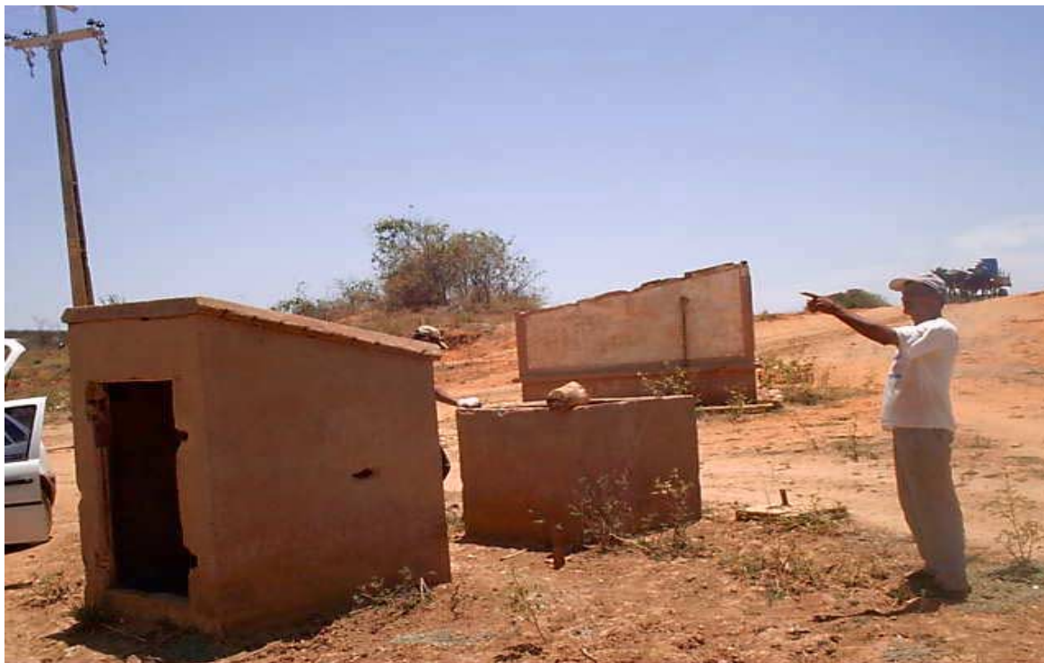
Foto 5.1 – Condições pretéritas do poço, verificadas durante o diagnóstico
