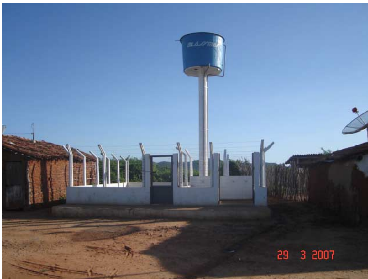
Foto 8.1 - Caixa d'água elevada e instalações no SSA Sítio Umarizeiras II
