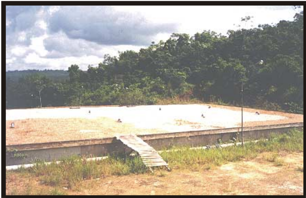
Foto 22 - Vista do reservatório semi-enterrado, para armazenamento de Água tratada.
