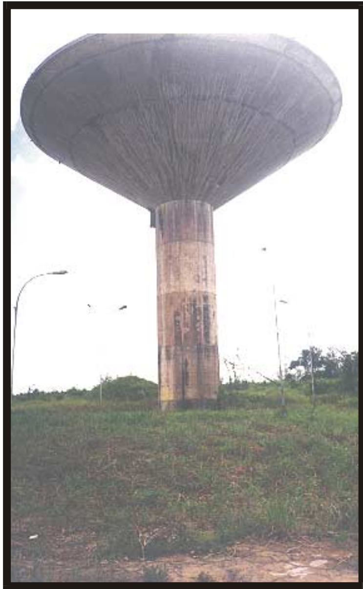
Foto 23 - Vista do reservatório Elevado, para abastecimento de água de Laranjal do Jari.
