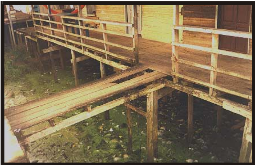
Foto 26 - Vista do triste aspecto proporcionado pela água estagnada sob os prédios residenciais.
