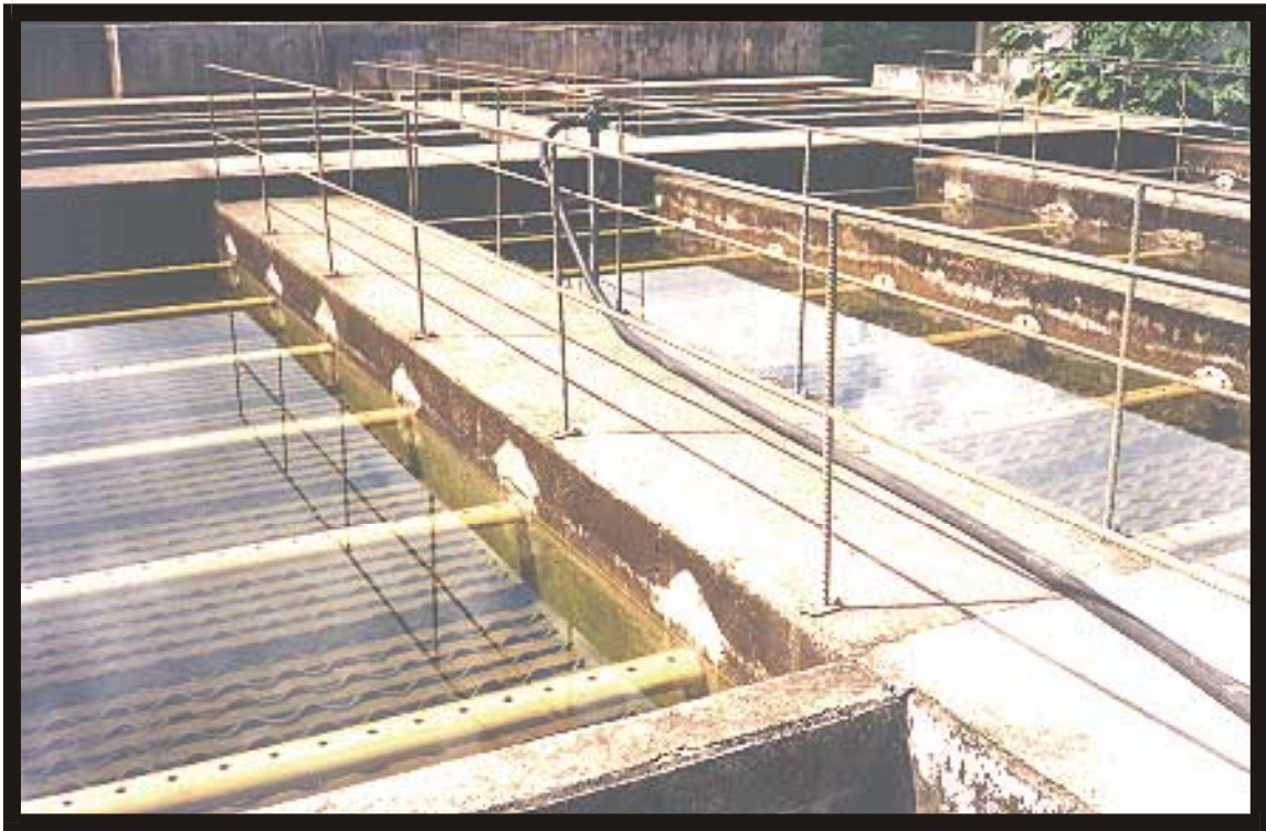
Foto 20 - Aspectos da Estação de Tratamento de Água - ETA - da Companhia de Água e Esgoto do Amapá - CAESA.
