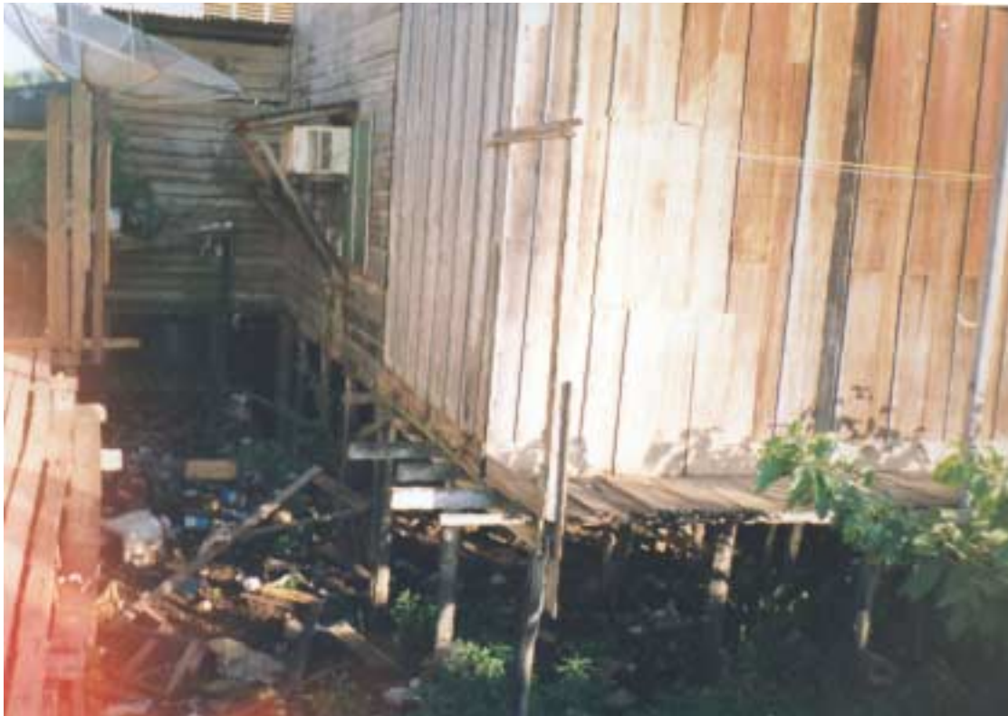
FOTO 07: Observa-se o lixo depositado na zona alagada sob as palafitas.
