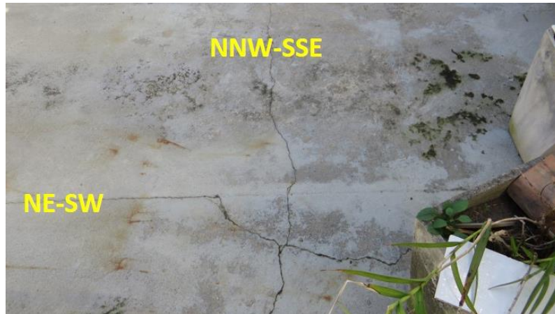
Figura 7: Trincas com orientações distintas, principal (NNW-SSSE) e secundária (NE-SW).
