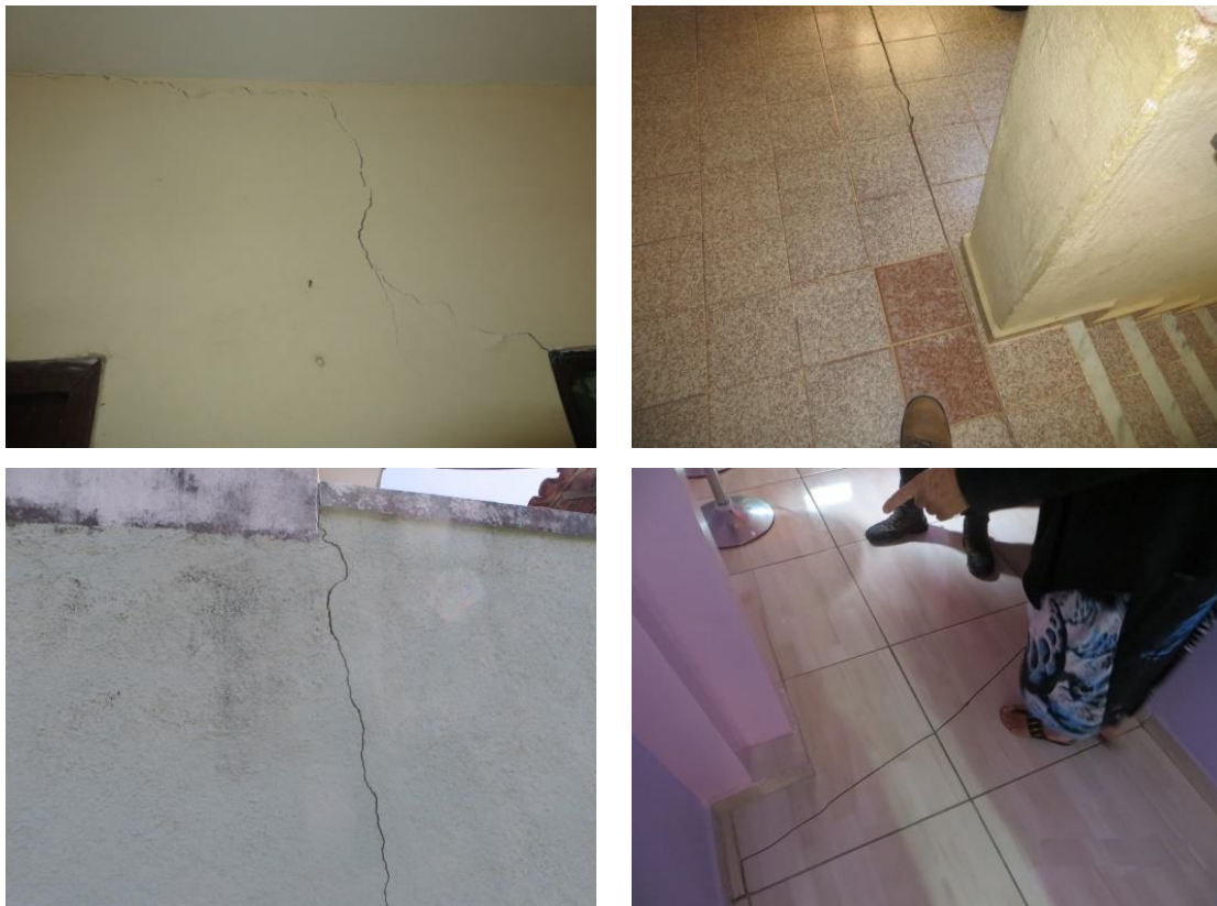
Figura 5: Características das trincas que retratam a área de média instabilidade no terreno.
