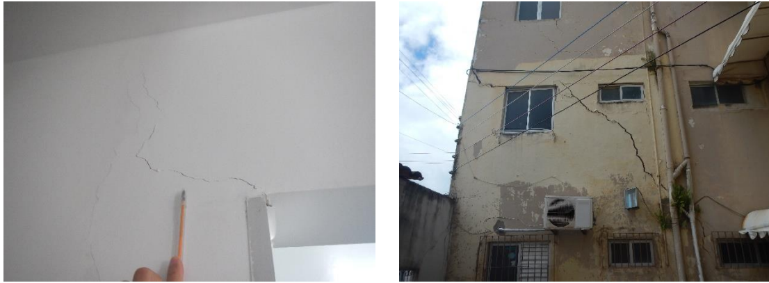
Figura 10: Trincas que evoluíram significativamente de junho a setembro de 2018.
