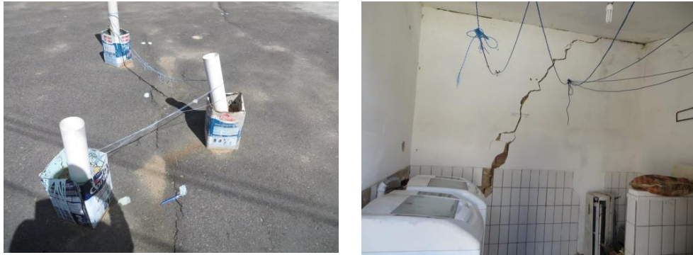
Figura 4: Características das trincas que retratam a área de alta instabilidade no terreno.
