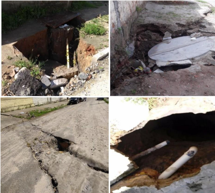
Figura 9: Surgimento de buracos e crateras de pequeno a médio porte nas vias (fotos retiradas do relatório preliminar da Defesa Civil de Alagoas).
