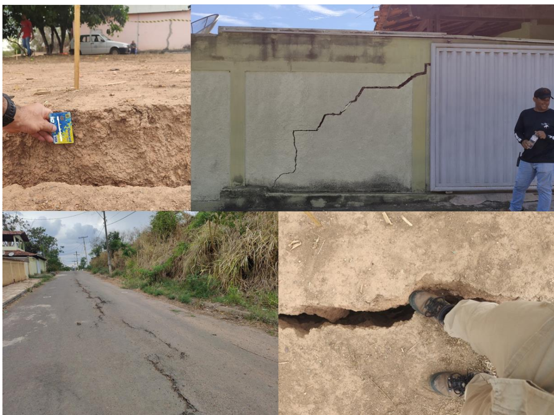
Figura 1 - Trincas e Afundamentos Observados na Área.
