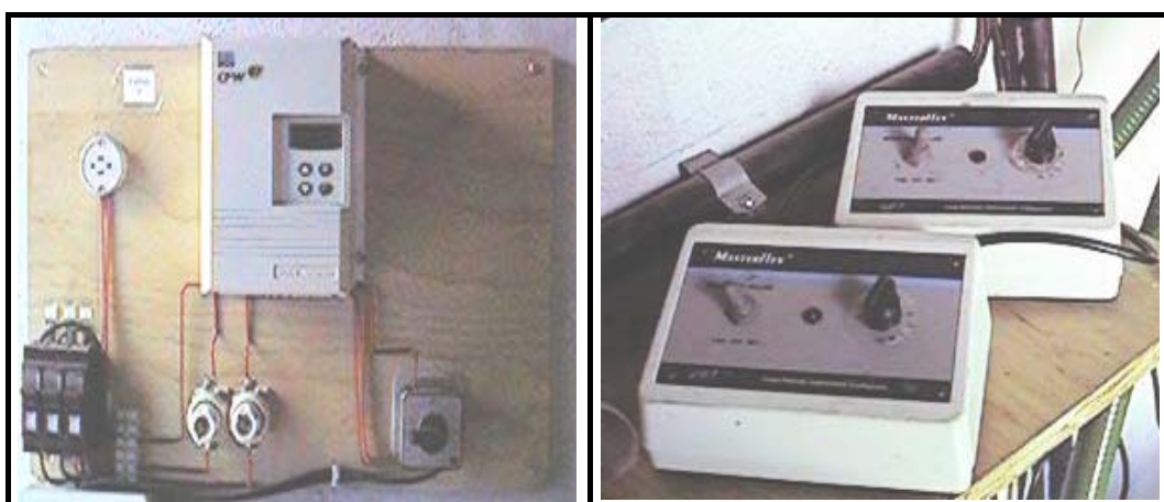
Figura 4.7: Controladores de frequências do moto redutores e bombas de alimentação
