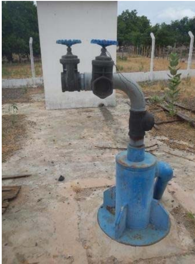
Fotografia 7: Detalhe do cavalete (saída) do poço (2021)
