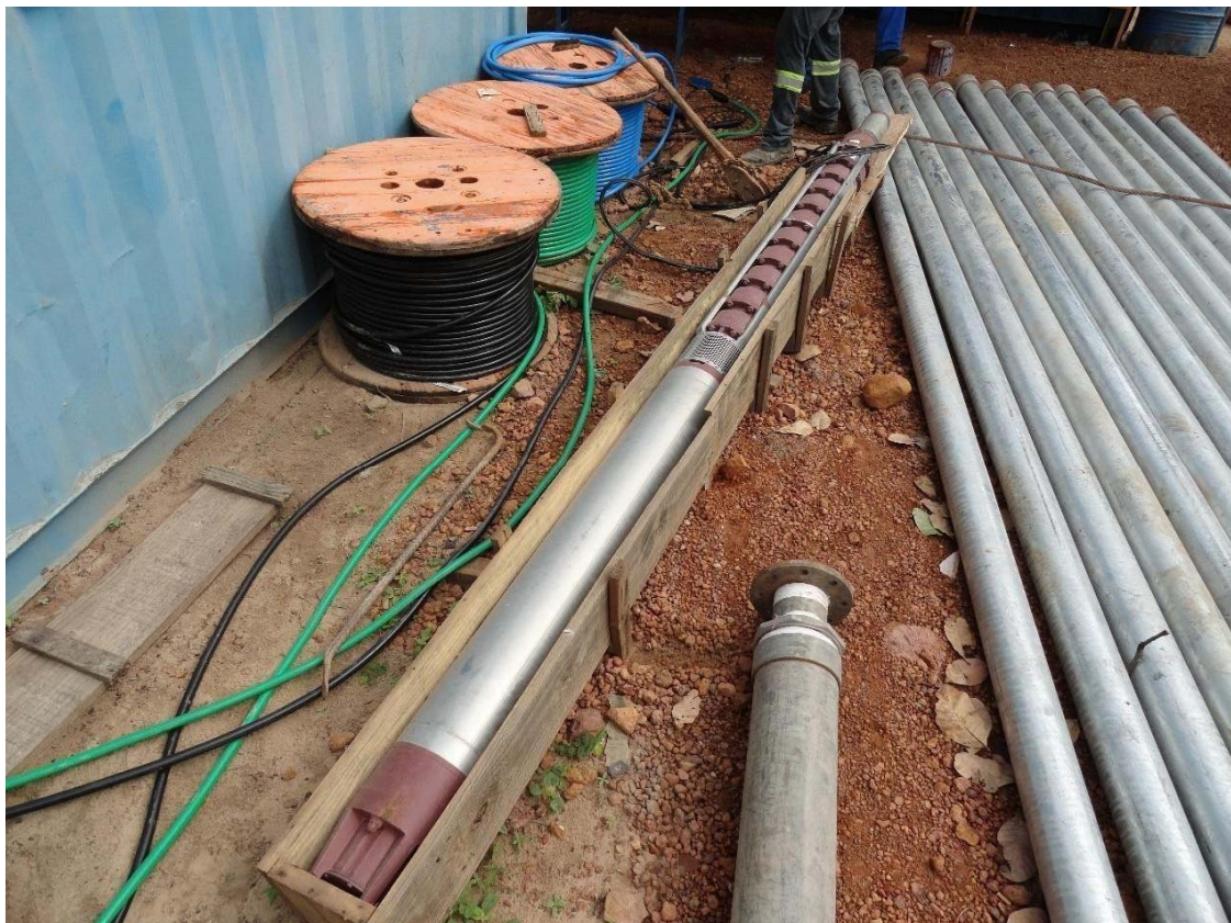
Fotografia 6: Bomba submersa original, fiação e tubos edutores para instalação (2013)
