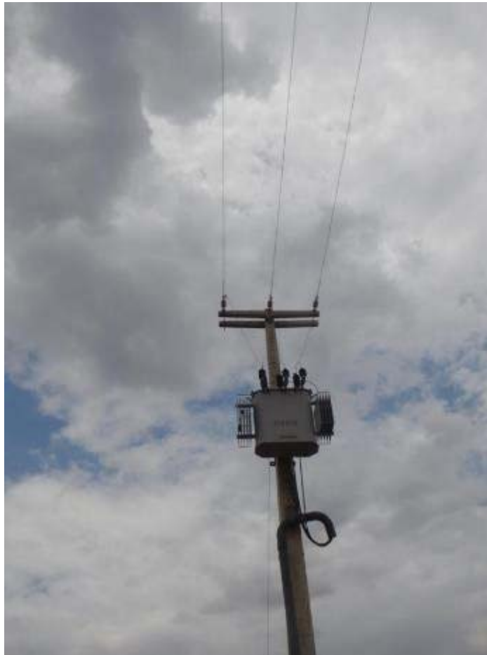
Fotografia 5: Transformador e rede elétrica
