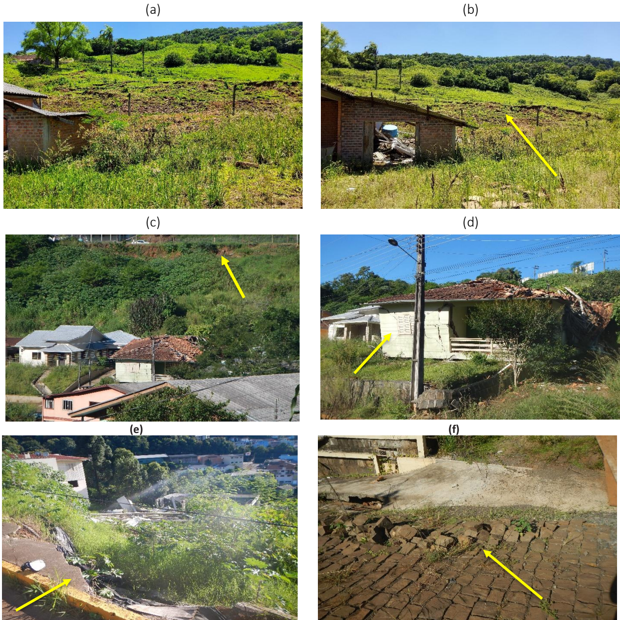
Figura 12 – Desastres e danos causados por movimentos de rastejo em solos derivados de basalto da formação Serra Geral em outros municípios: (a) e (b) Dano em residência de alvenaria em encosta de baixo aclive, por pulso de movimentação do processo de rastejo na Av. Albino Meinhart, município de Igrejinha/RS. Notar trinca de movimentação semelhante às observadas nas ruas da Azaleia e Augusto Orlandi. A área foi mapeada e consta no setor de risco SR 42 do SGB-CPRM (2019); (c) Danos em encosta decorrentes de rastejo evoluindo para possível deslizamento rotacional no município de Concordia/SC no bairro Parque de Exposição. Setor de risco mapeado pelo SGB-CPRM (2019) como Setor 27; (d) Casa de alvenaria danificada em pulso de movimentação em terreno de baixo aclive, notar trincas radiais de deformação; (e) Trincas de movimentações reconhecidas no local.
