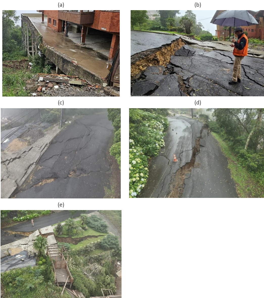
Figura 4 – Edifício Condado Ana Carolina apresentando problemas estruturais: (a) Deformações observadas nas colunas de sustentação; (b) Abatimento de terreno apresentando trincas no solo de ordem de 0,5 a 1 m; (c) Trincas em formato radial; (d) Trinca de ordem de 0,5 m longitudinal à pista da rua e (e) Trinca reconhecida pós colapso.
