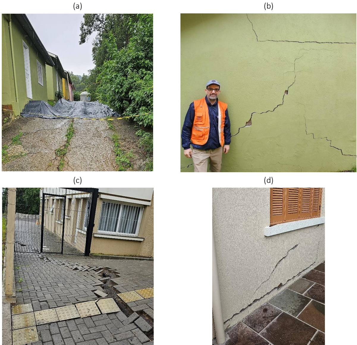
Figura 10 – Trincas reconhecidas no bairro Loteamento Orlandi: (a) Residências apresentando trincas no solo, colocado lona sobre estas com o fim de evitar a infiltração de águas das chuvas; (b) Trincas dispostas em diagonal em casa de alvenaria podendo estar relacionado com movimentação do solo; (c) Trinca em solo próximo a residência e (d) Trinca diagonal em parede de alvenaria indicando movimentação de solo sob residência.
