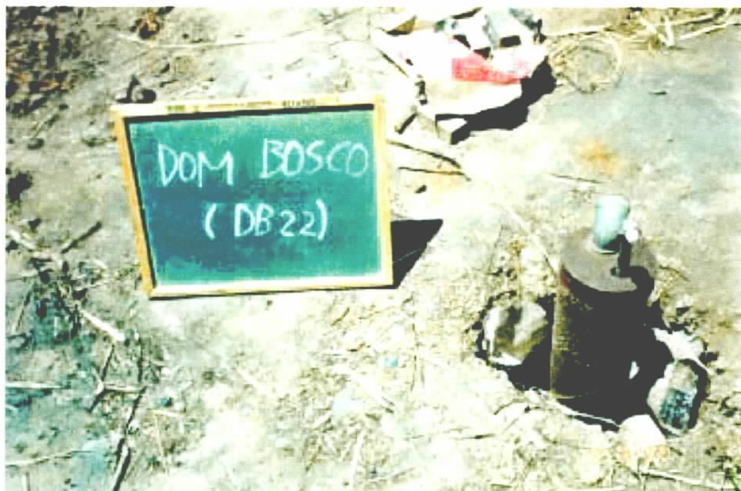
Foto 3 - Poço tubular com risco potencial de contaminação elevado, em razão da deficiência construtiva, notando-se ausência de cimentação do espaço anelar e da laje de proteção sanitária. Essa situação facilita a infiltração de água superficial e contaminantes. Local: Fazenda Gado Bravo. UTM: 361766E/8148994N.
