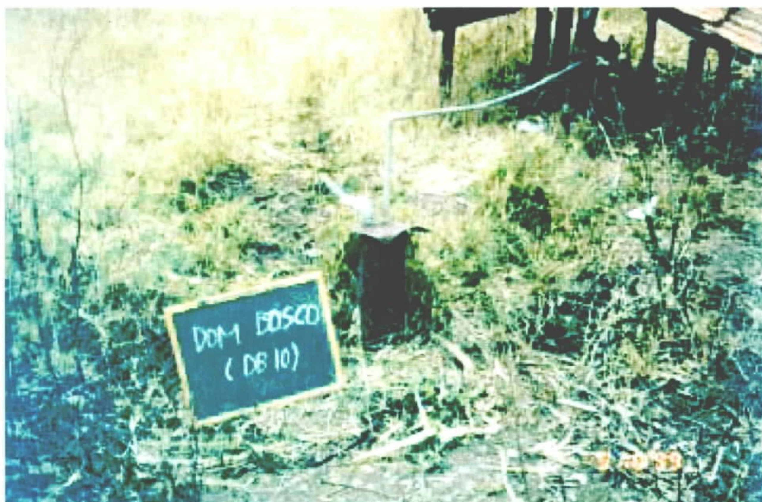
Foto 6 - Poço tubular produtivo mostrando ausência da laje de proteção sanitária, tampa não apropriada e baixa qualidade de revestimento. Local: Fazenda Vargem Bonita. UTM: 366722E/8159588N.
