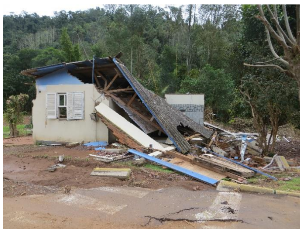
Figura 9 – Aspecto dos danos em residências causado pela inundação do Arroio Tamadué.
