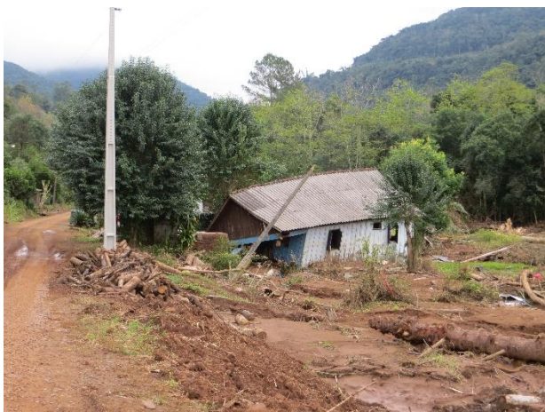
Figura 6 – Moradia com rachaduras na rua Bento Gonçalves.
